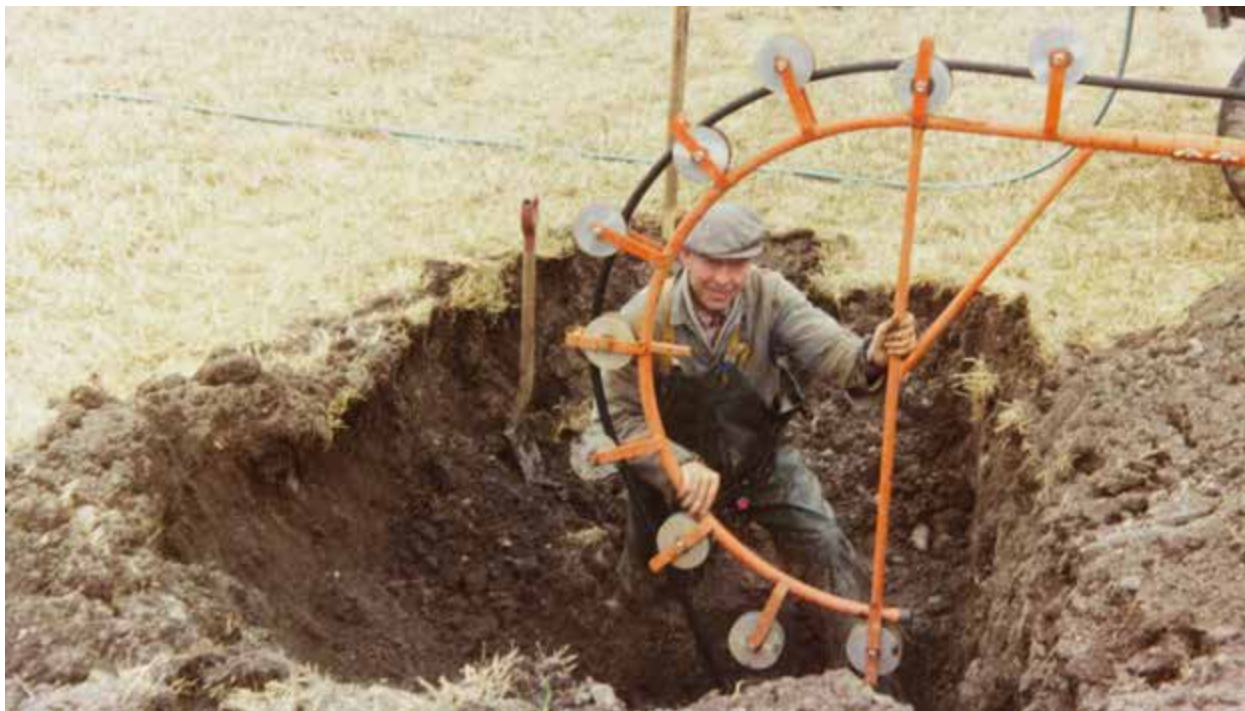
Odd Kvasdheim sjekkar at alt går rett for seg under grøftinga. Foto: Privat eige.
