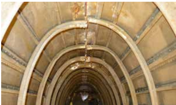
Bilde 6: tre spant i «taket» av bakkroppen ble deformert som følge av flyets vekt hvilte på dette stedet via noen bildekk.
