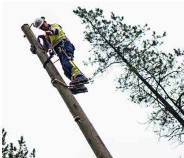
Å jobbe høyt i mastene er en ferdighet montørene må beherske. Her er energimontør Kristian Serigstad i arbeid. Foto: Tord Paulsen
