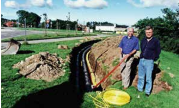
I 1998 ble Jæren Fjernvarme etablert. Her inspiserer everkssjef Alv Hetland og energiingeniør Jan Holgersen fjernvarmeledningene som går forbi Jæren Everk sitt kontor i Bernerveien. Bildet er tatt i 1999. Foto: Jæren Everk.
