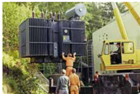
Ny trafo har ankommet og monteres ved Hetland kraftstasjon i 1988. Foto: Jæren Everk.
