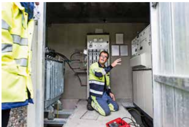
Energimontør Torstein Bernssen kontrollerer en nettstasjon. Foto: Tord Paulsen.
