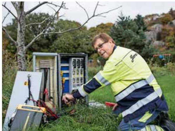
Andre montører arbeider veldig nær jorda. Her driver energimontør Torstein Bernssen med kabelpåvisning. Foto: Tord Paulsen
