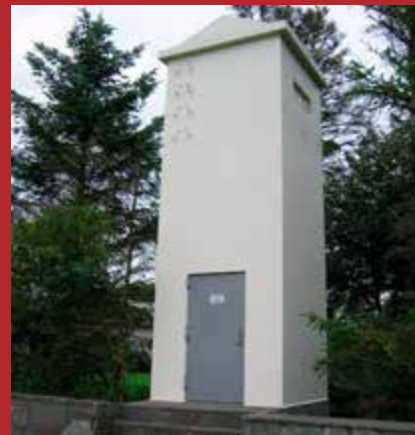
Nr 231 – Kaffiholen er ein av dei mange trafokioskane som blei bygde. Foto: Birger Høyland, Jæren Everk.
