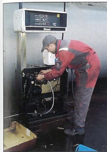
Gartneriet på Opheim bruker mykje drivstoff, både til drivhusa og til traktorar og anna utstyr. Derfor har dei eigen drivstofftank. Då bensinstasjonen på Pollestad skifta ut sine pumper denne hausten, fekk Thomas hand om ei av desse. Så nå har dei ein hendig tappestasjon på garden.
